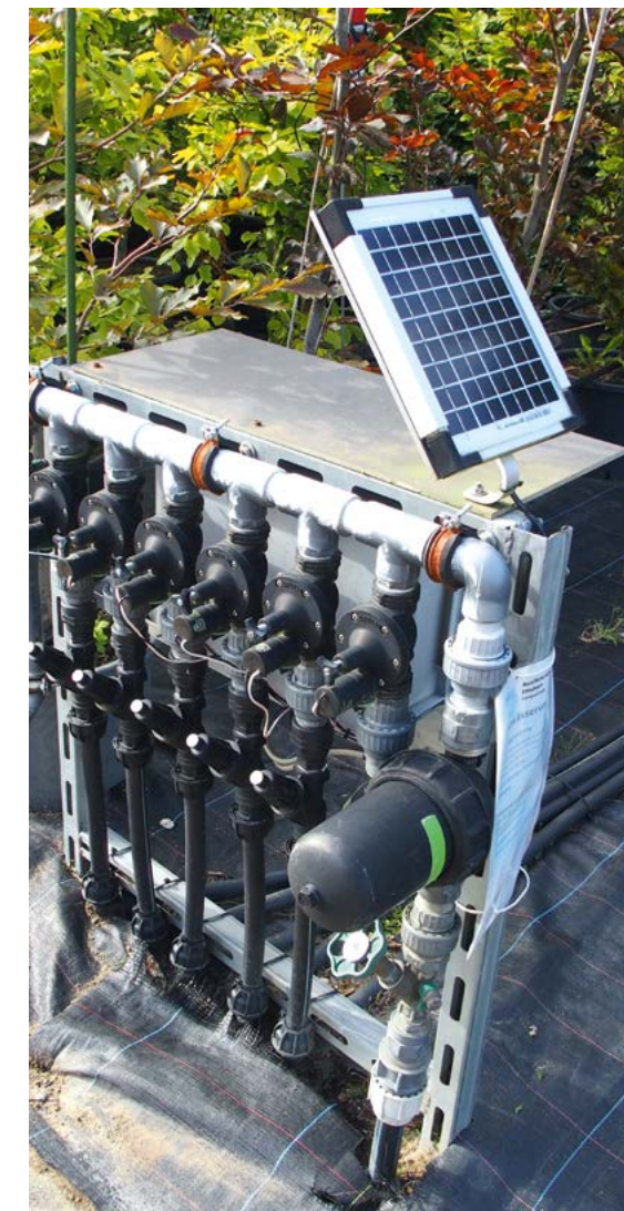
Magnetventile mit solarbetriebener Funkventilsteuerung
